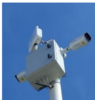
2 cameras Bullet + switch PoE + Pont radio émetteur
